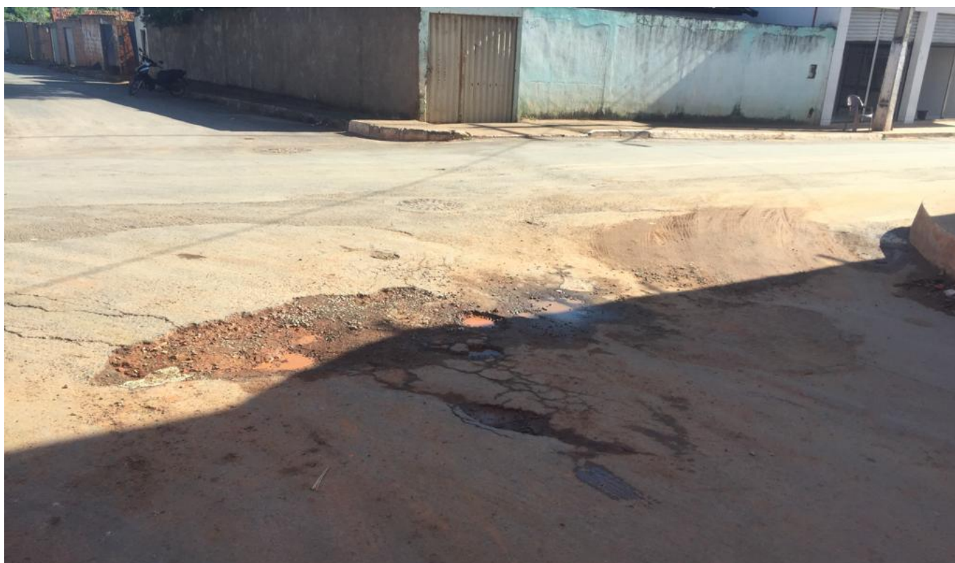
FOTO N° 06: RUA SEBASTIÃO ALVES DE AQUINO COM AV. DR. GERALDO ATAIDE – IMAGEM ANTES DA OBRA
